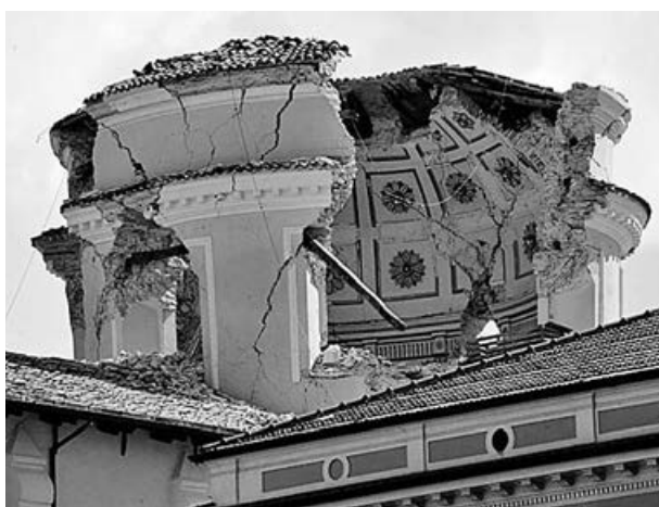
Destruição da cúpula da igreja de Santa Maria del Suffragio em Áquila
